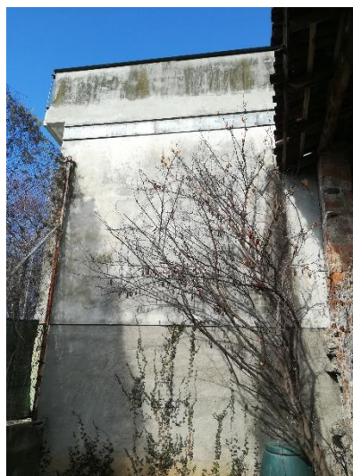
Parete in calcestruzzo da consolidare
