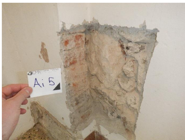
Asportazione di intonaco su spigolo interno: ingresso posteriore
